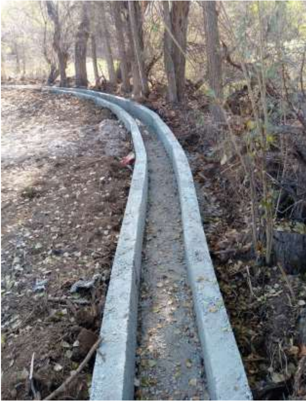
Kelkit Babakonağı Sulama Tesisi
